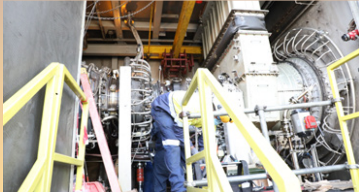
Mafundi wakiendelea na kazi ya utengenezaji wa moja ya mtambo wa umeme katika kituo cha umeme cha Songas kilichopo Ubungo mkoani Dar es Salaam.
