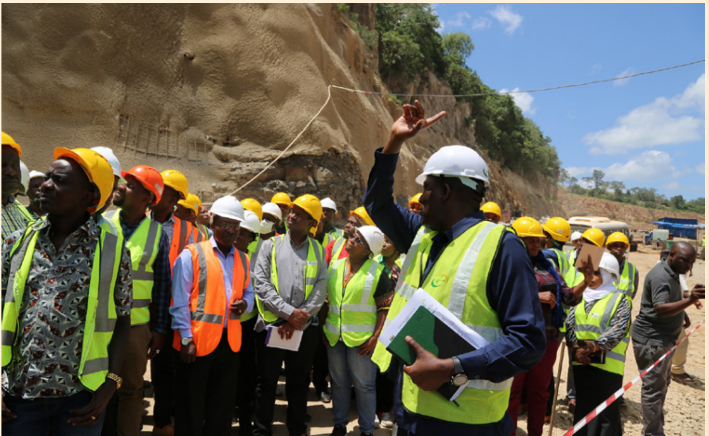
Mhandisi Mkazi ambaye pia ni mshauri wa mradi huo, Mhandisi John Mgeni akiwaonyesha kitu Wajumbe wa Kamati ya Kudumu ya Bunge ya Nishati na Madini walipofanya ziara ya kukagua maendeleo ya ujenzi wa mradi wa JNHPP mkoani Pwani, Machi 12, 2021.
